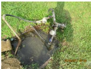
Une fuite avant compteur.
