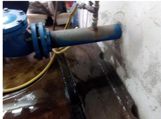
Image 3 : Fuite d'eau au niveau du surpresseur de Lekolo
