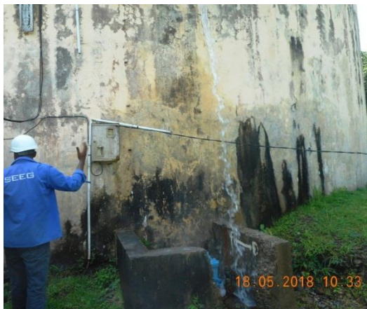
Image 6 : Débordement du réservoir de Mounana
