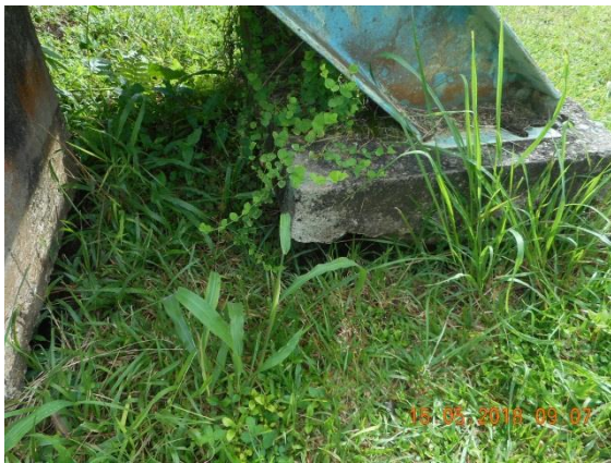
Image 1 : Déchaussement de la prise eau brute
