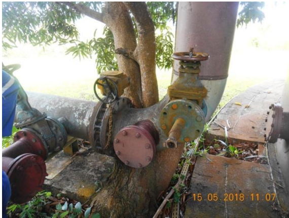
Image 3 : Présence d'un arbre accolé à la conduite de refoulement d'eau brute
