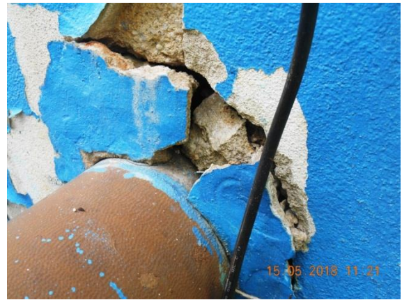
Image 4 : Fissures dans le mur, causées par la conduite de refoulement d'eau brute : Station de reprise
