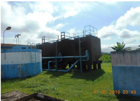
Image2 Station de traitement d'eau Dégrémont de 50m 3 /h
