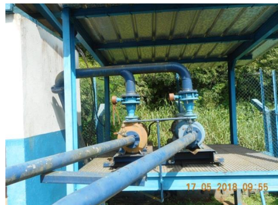
Image 1 Pompe de refoulement eau brute appartenant à l'ancienne installation
