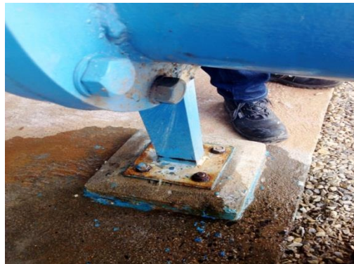
Image 3 Fuite d'eau filtrée
