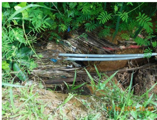
Image 4 Câble d'alimentation électrique de la prise d'eau brute à nue
