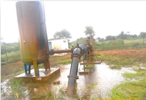
Photo1 : Dégradation de l'environnement du site du forage F3.
