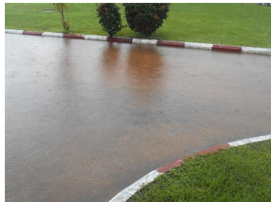
Photo 4: Inondation du site de l'usine de potabilisation de Port-Gentil due à l'absence d'évacuation d'eau pluviale
