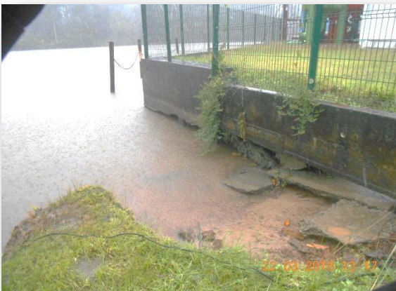
Photo 3 : Erosion de la berge de la station de pompage de Mandorové
