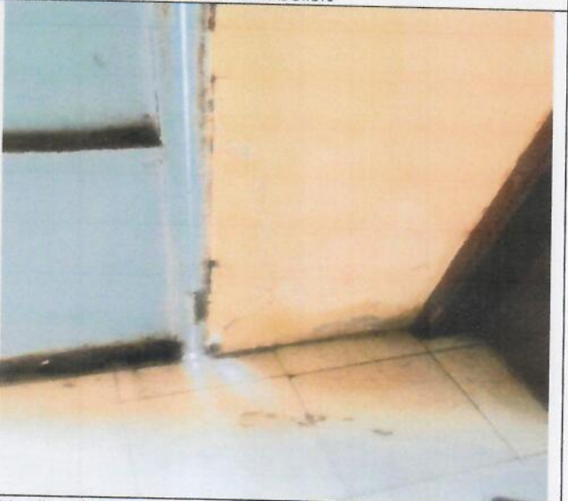
Mur fissuré du bâtiment des pompes doseuses
