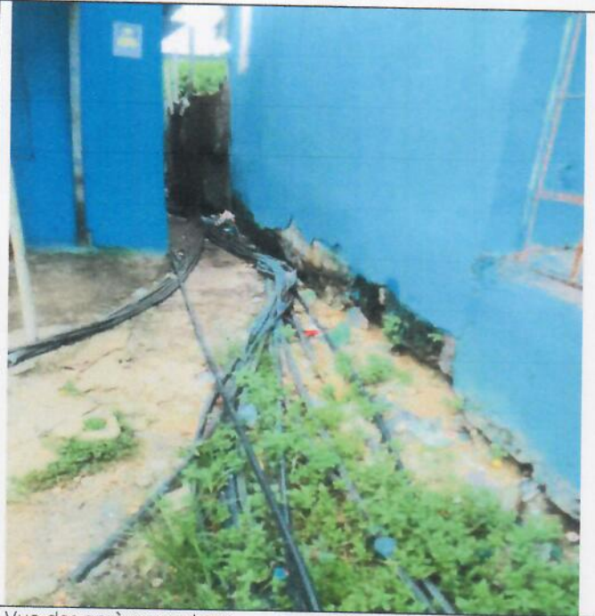
Vue des après compteurs
