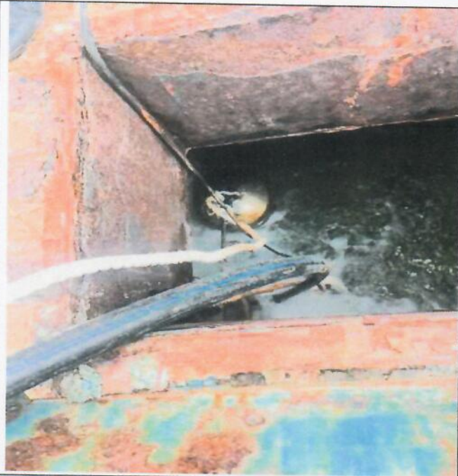
Robinet flotteur du surpresseur d'Awoungou est hors service et la bache eau traitée est rouillée
