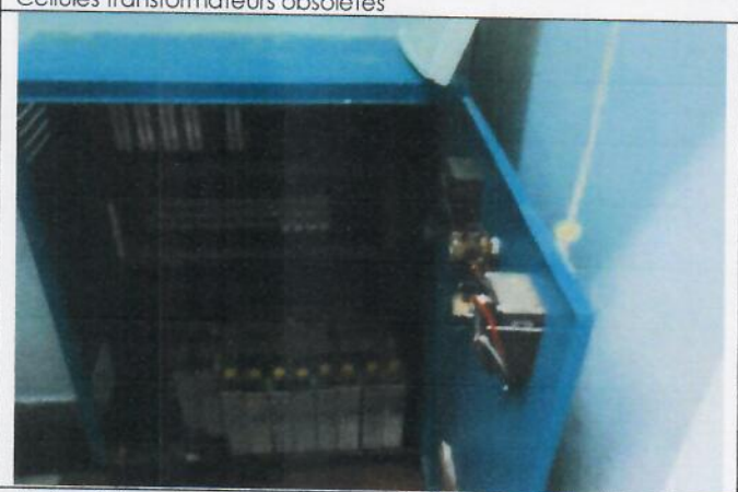
Atelier d'énergie hors service
