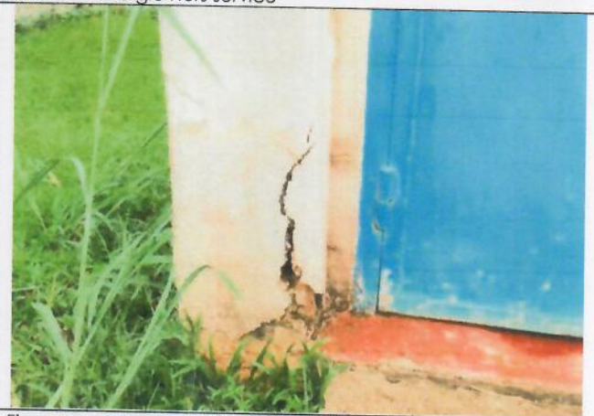
Fissures sur le bâtiment abritant les groupes
