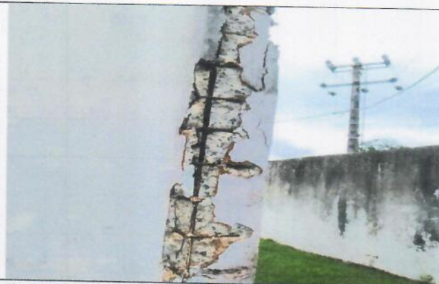
Fissures sur le bâtiment
