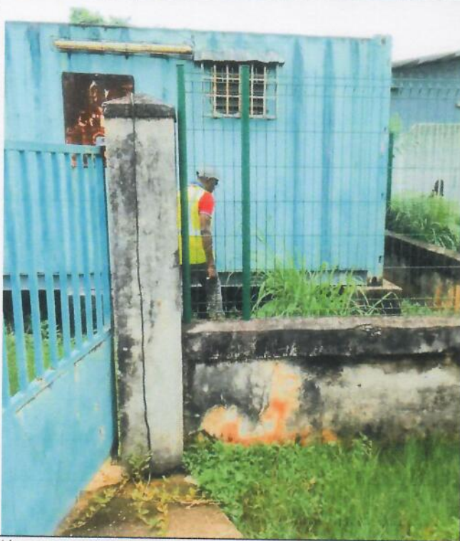
L'espace vert du surpresseur d'Alibandeng n'est pas entretenu
