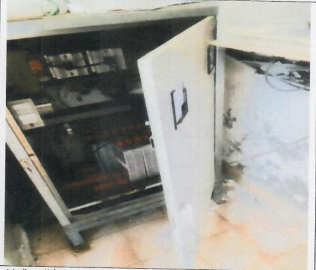
Atelier d'énergie hors service
