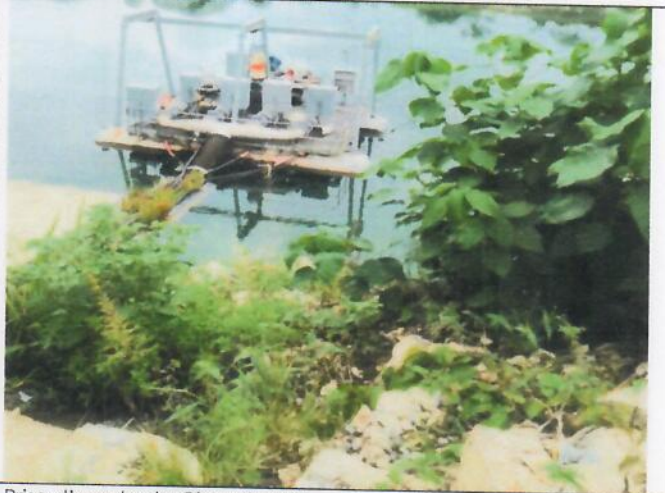
Prise d'eau brute Cimgabon 2
