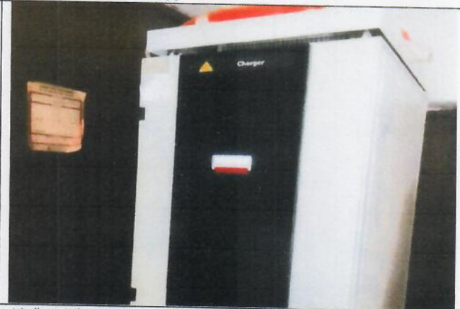
Atelier d'énergie Hors service
