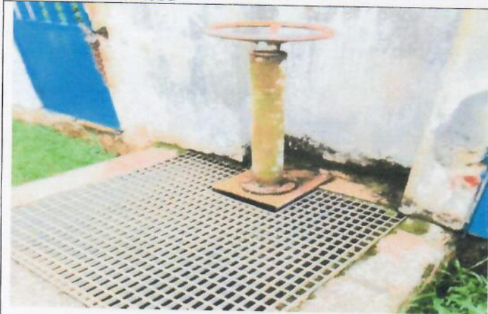
Batardeau hors service
