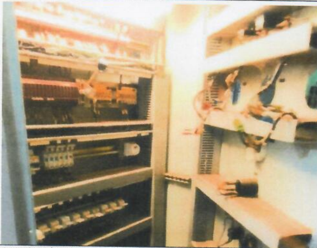
Armoires électriques vétustes
