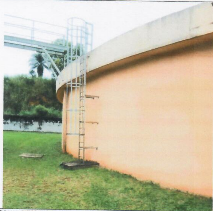
Réservoir 7500m 3 du PK9 ne se remplit pas
