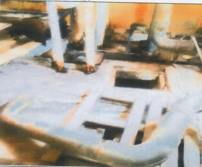
Risque d'effondrement du plancher du bâtiment des pompes doseuses
