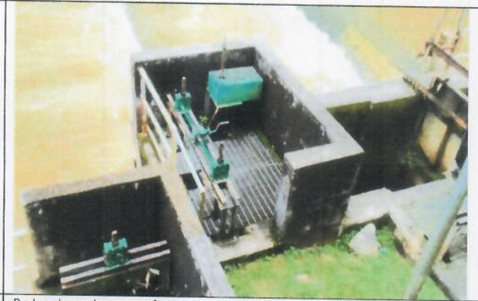
Batardeau hors service
