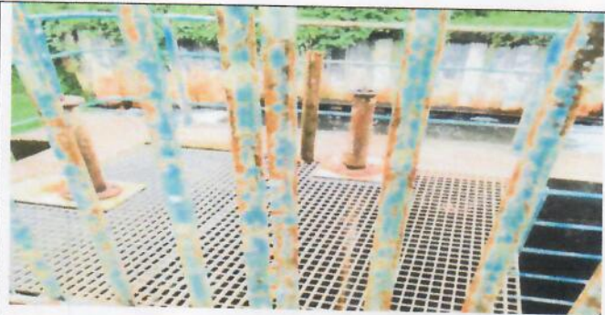
Batardeaux hors service
