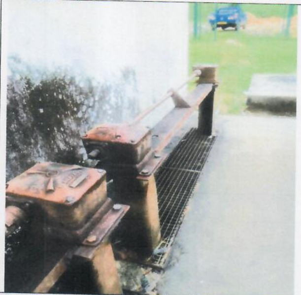
Batardeau hors service
