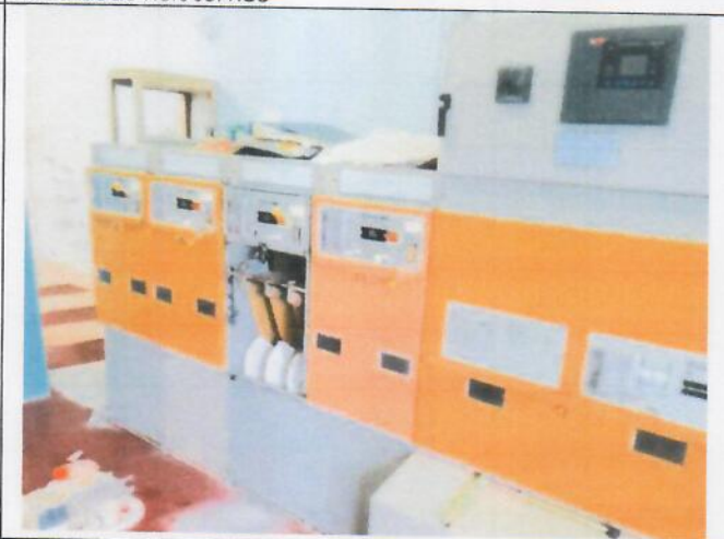
Cellules transformateurs obsolètes
