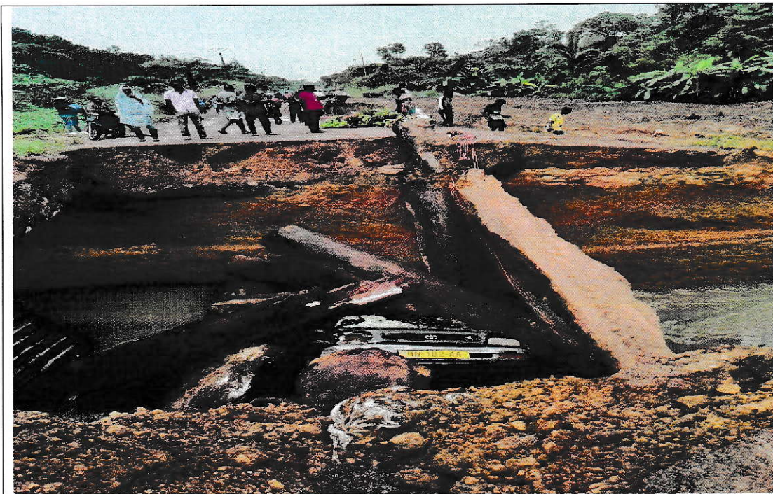
Effondrement d'un pont à Meba : accès difficile aux stations de transfert de Meba, Saza et Mbe
