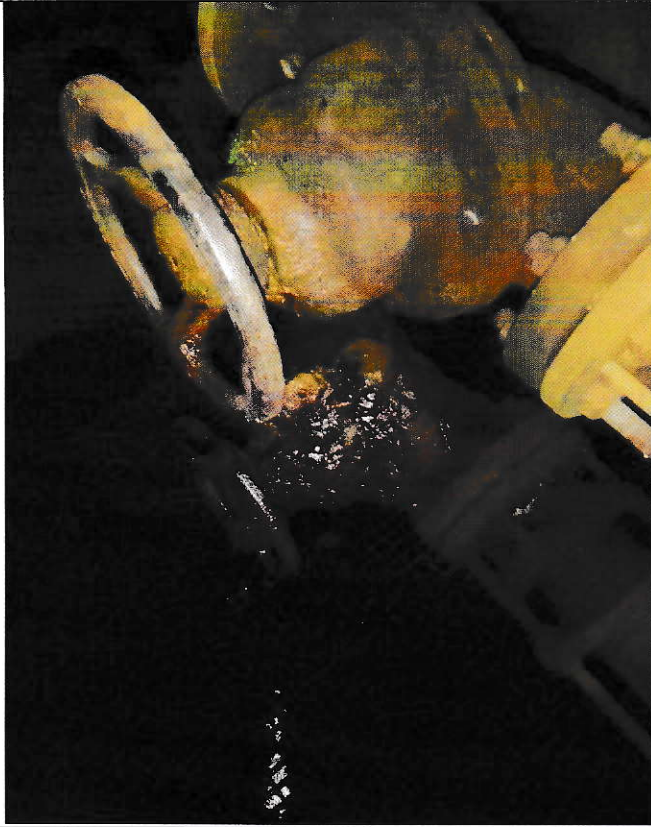
Vanne d'extraction de boue corrodée
