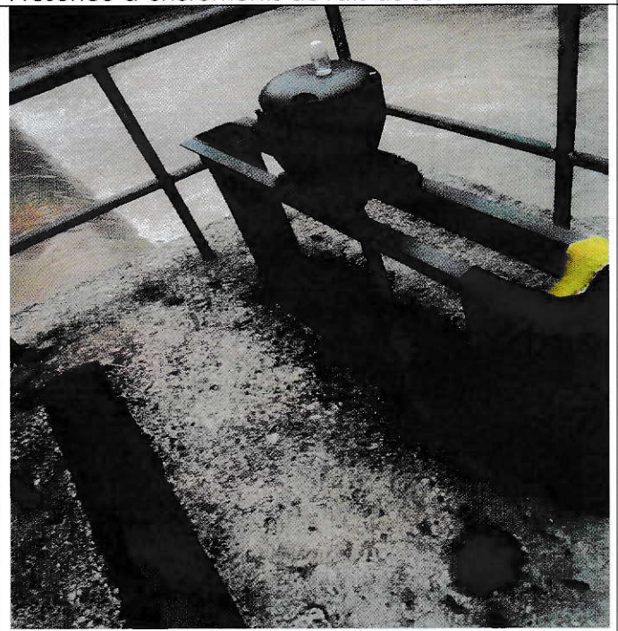
Batardeau hors service
