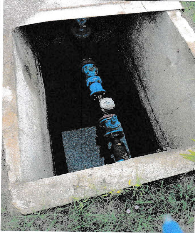
Arrivée d'eau de la station de traitement de Mvengue
