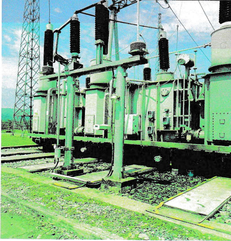
Décalage de l'entretien du transformateur 225/63 KV
