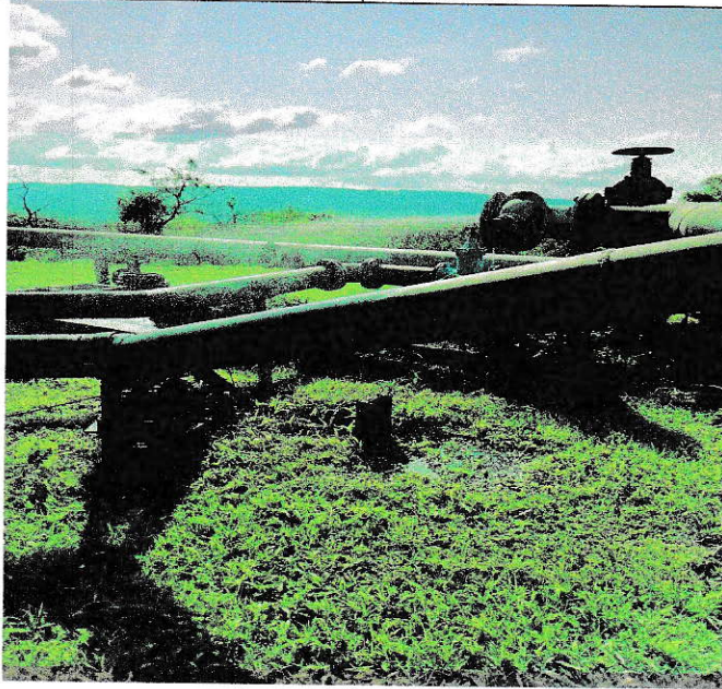
Fuite d'eau au niveau de la vanne de la conduite de la station de reprise
