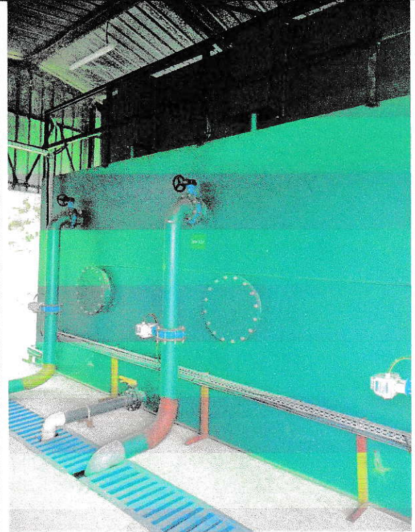
Nouvelle station de traitement d'eau
