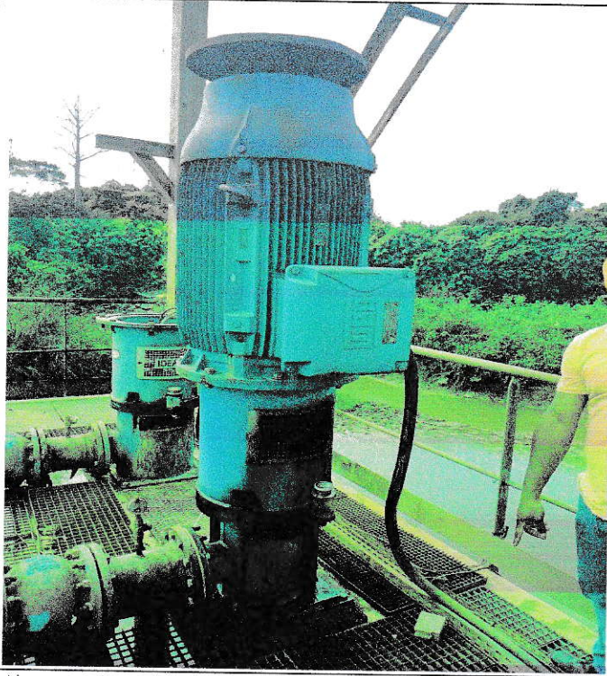
Absence du moteur de la pompe de secours
