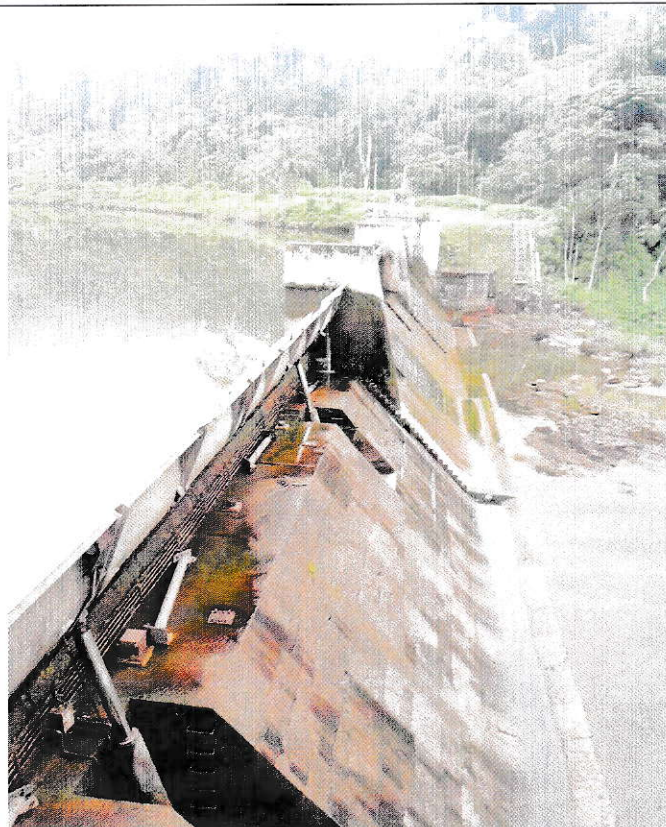
Problèmes d'étanchéité au niveau des clapets de surélévation du barrage
