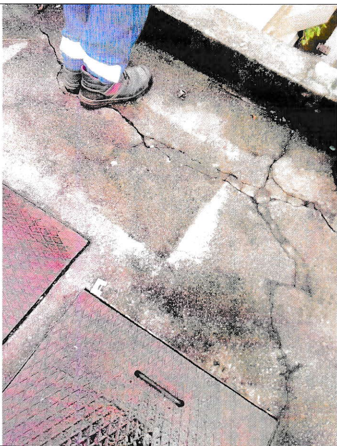
Fissures sur la dalle du portique du batardeau
