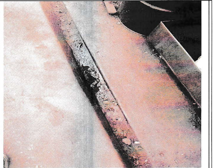
Absence d'un circuit séparatif eaux/huiles
