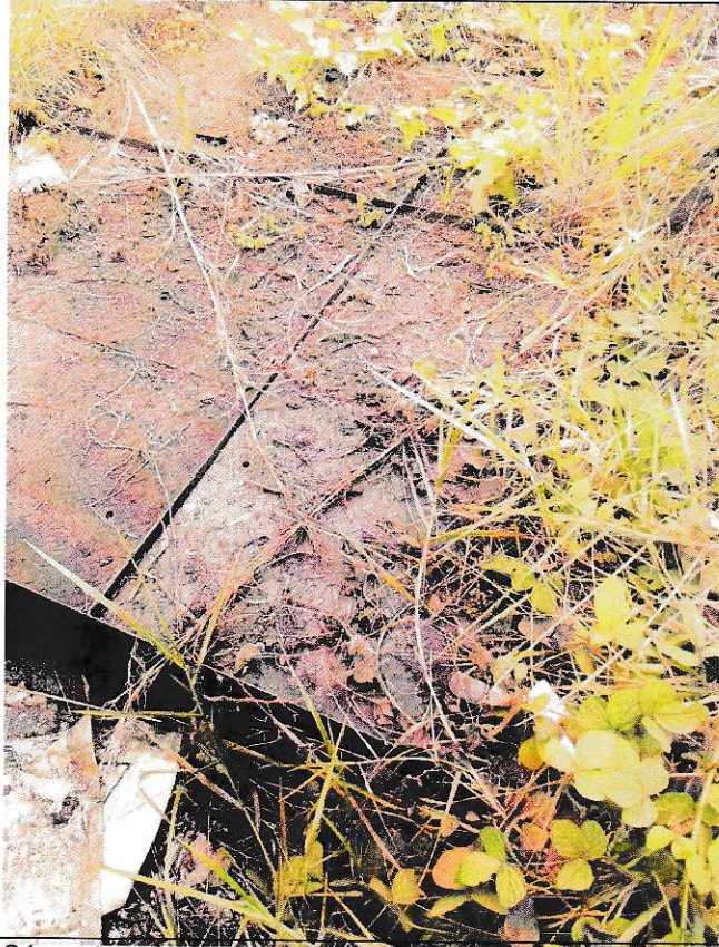
Séparateur à réhabiliter
