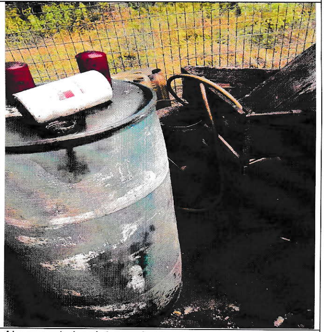
Absence de local de stockage des déchets
