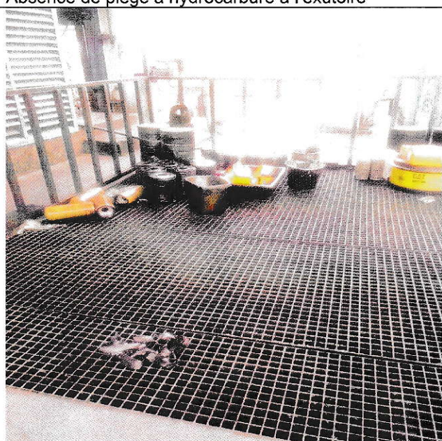
Séparateur non fonctionnel
