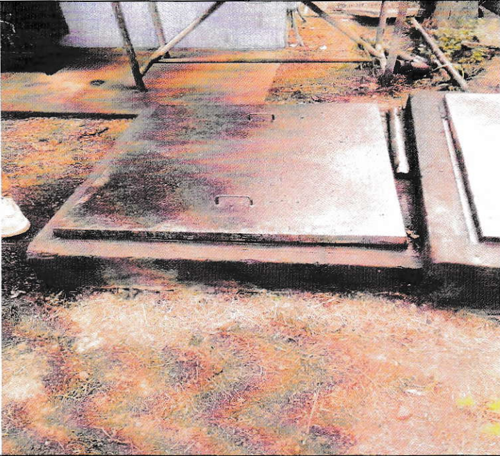
Séparateur non fonctionnel
