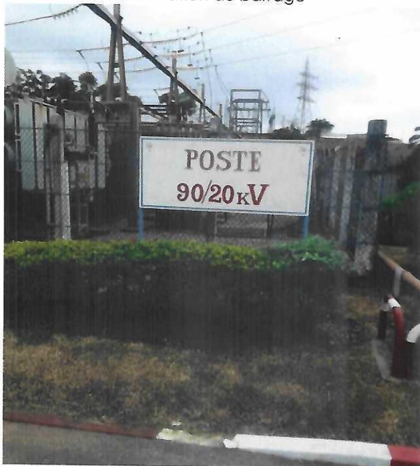
Centrale d'Akournam : Poste 90 KV
