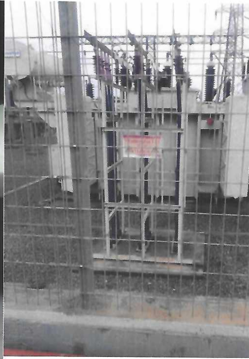
Centrale d'Alenakiri : Poste 90 KV
