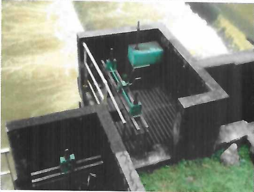
Station Mbé : Batardeau hors service
