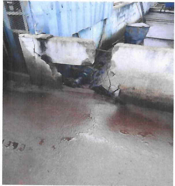
MOUILA : Bac de rétention stockage de combustible
