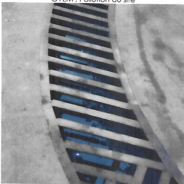
OYEM : Absence de circuit séparatif eaux/huiles
