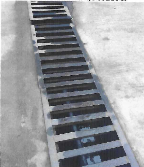
MOUILA : Absence de circuit séparatif eaux/huiles
