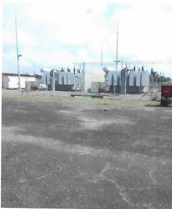
Centrale thermique de la SEEG : Poste 20 KV
