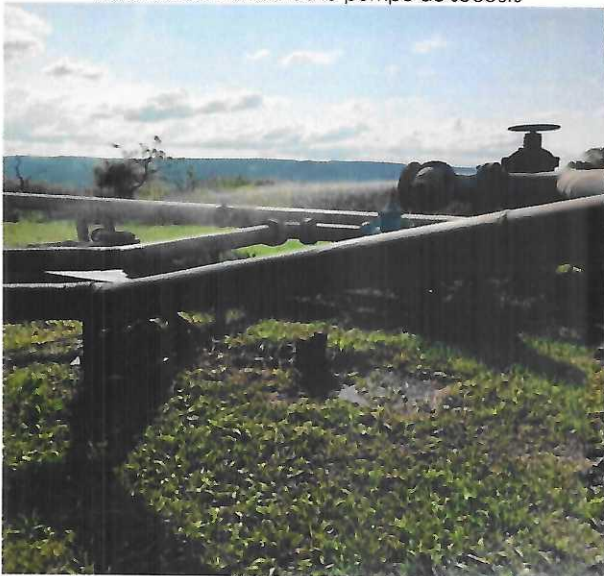
Fuite d'eau au niveau de la vanne de la conduite de la station de reprise d'eau de Mounana
