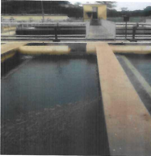
Station de traitement NTM3/4 : Lit de boues au niveau des filtres
