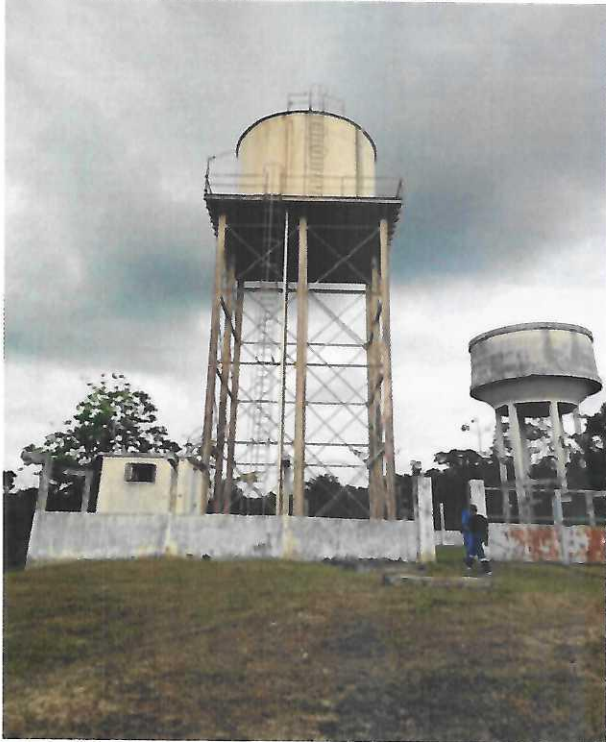
Station de traitement d'eau de Bongoville : Château d'eau en béton non fonctionnel à côté du château d'eau métallique
