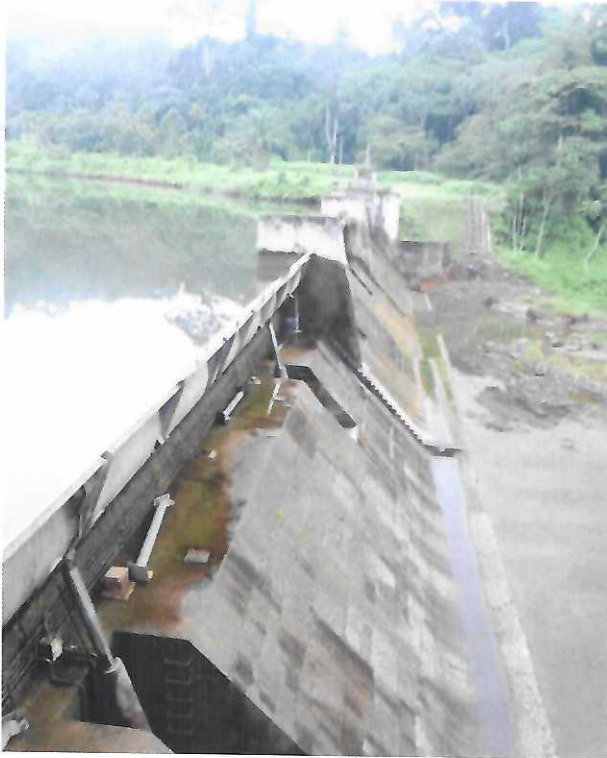
Centrale de Kingulé : Problèmes d'étanchéité au niveau des clapets de surélévation du barrage
