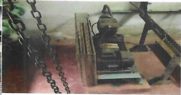
Station Saza: Compresseur à renouveler
