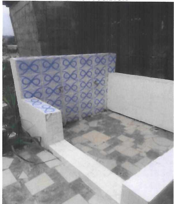
CNEE : Fontaine publique non fonctionnelle à Awendjé (absence d'eau)
