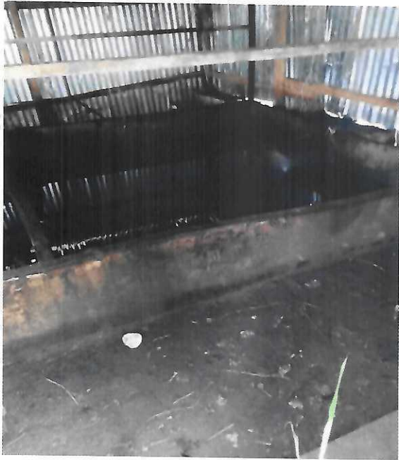
MOUILA : Séparateur hydrocarbures
