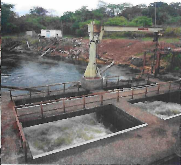
Poubara1 et 2 : Saturation de la prise d'eau par des bois flottants
