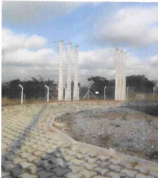
Centrale thermique du Cap Lopez : Départs HTA en attente de raccordement au poste de Ntchengue
