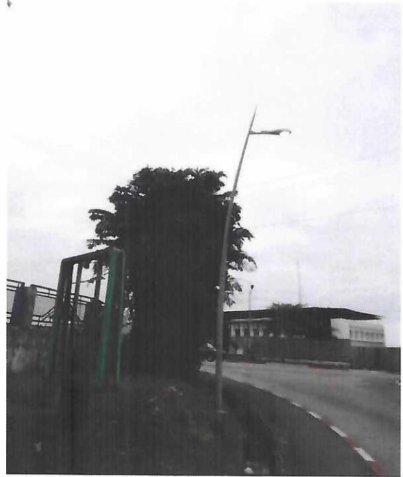
CNEE : Luminaire allumé en plein jour au niveau de l'ancien SOBRAGA
