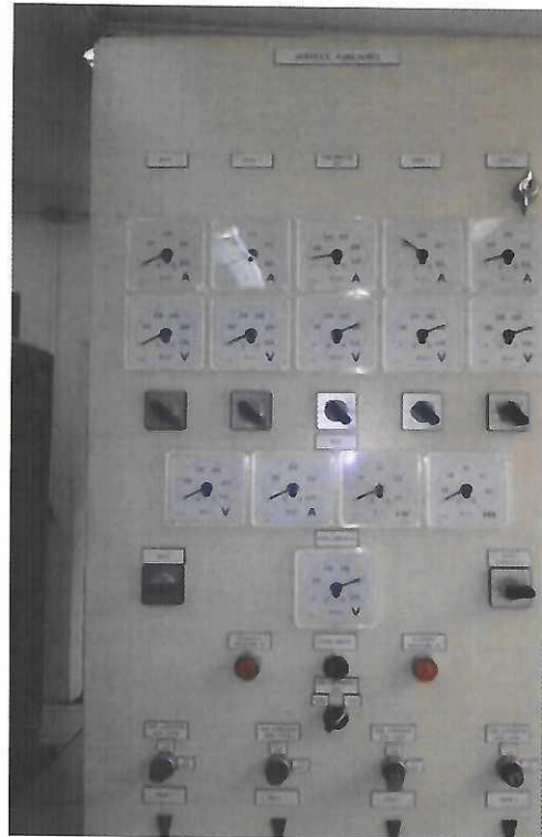
Centrale de Kingulé : Armoires électriques obsolètes
