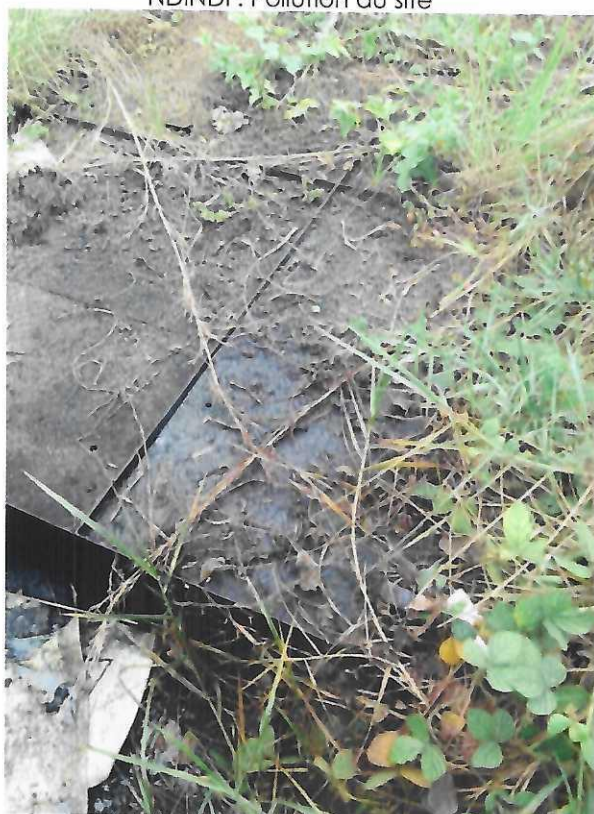
NDINDI : Séparateur à réhabiliter
