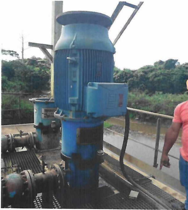
Station de traitement d'eau de Mounana : Absence du moteur de la pompe de secours
