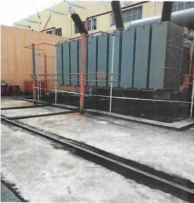
Grand Poubara : TR2 de Grand Poubara à remplacer
