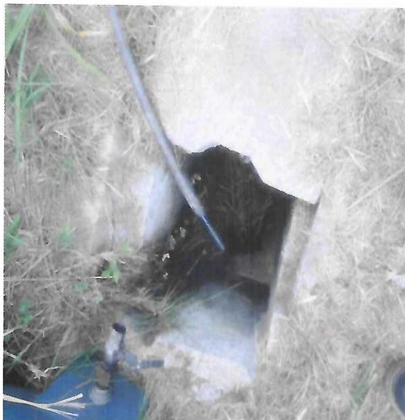
OYEM : Absence de piège à hydrocarbure à l'exutoire
