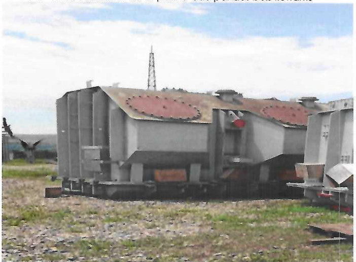
Transformateur de secours du poste SP de Moanda en attente d'installation
