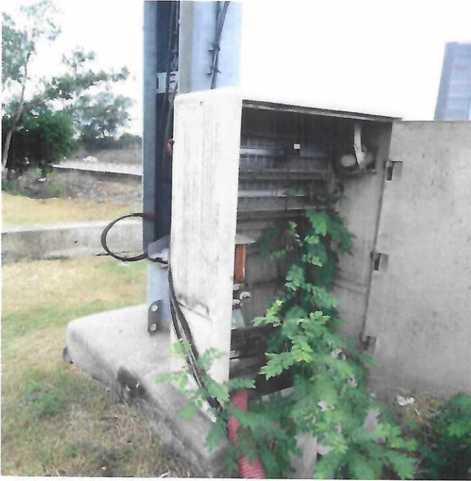
CNEE : Armoires vétustes à l'échangeur des Charbonnages
