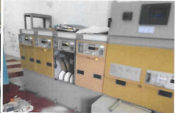
Station Mbé: Cellules transformateurs obsolètes
