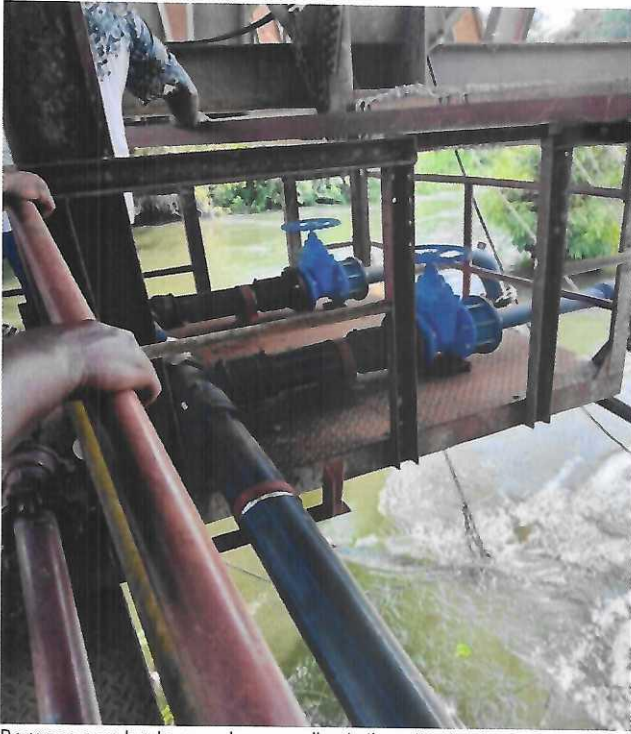
Pompes eau brute pour la nouvelle station d'Akieni
