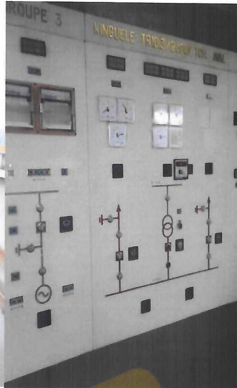
Centrale de Tchimbélé : Armoires électriques obsolètes
