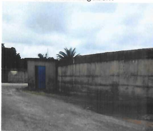
Réservoir de 5000m3 hors service au PK6
