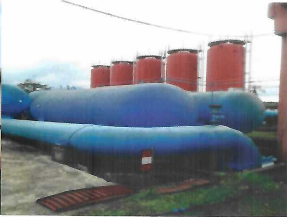
Station de traitement NTM5/6 : Vessie percée sur l'un des anti-béliers
