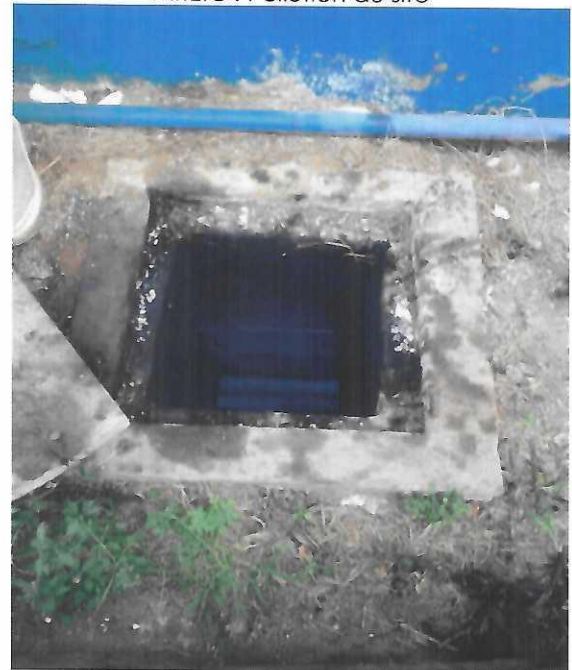
MITZIC : Absence de circuit séparatif eaux/huiles
