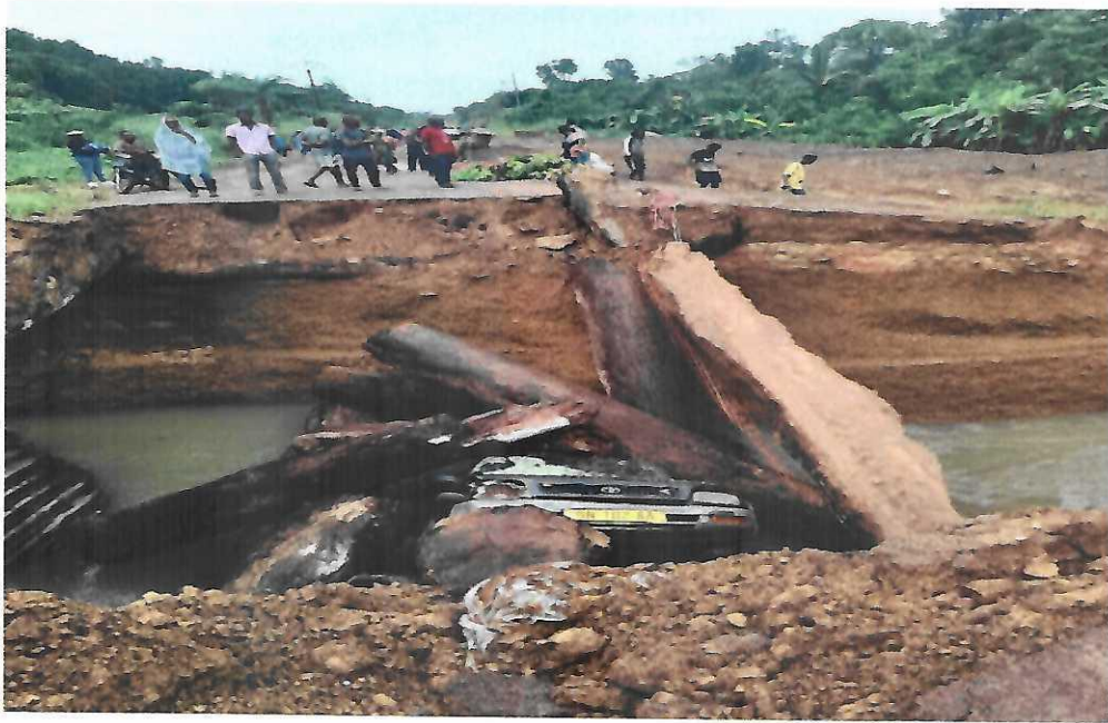
Effondrement d'un pont à Meba : accès difficile aux stations de transfert de Meba, Saza et Mbe
